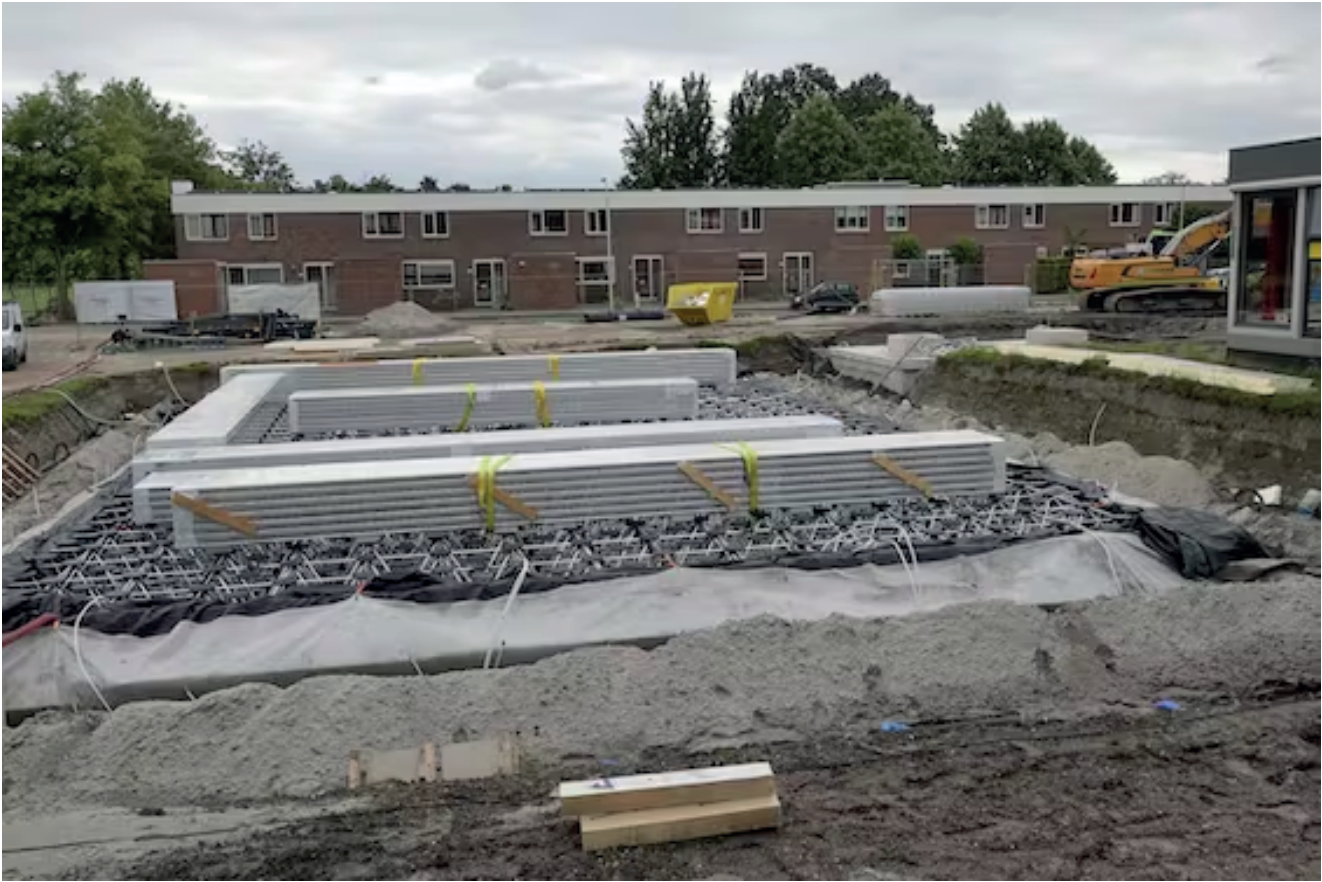
De aanleg van de seizoensbuffer voor het warmtesysteem in Nagele. Het brede, ondiepe bassin kon ondergronds worden aangelegd, waardoor er bovengronds ruimte over bleef. Uit dat bassin moest het leeuwendeel van de te leveren warmte komen. De praktijk bleek anders. (Foto: Fred Hoogervorst/ANP)
