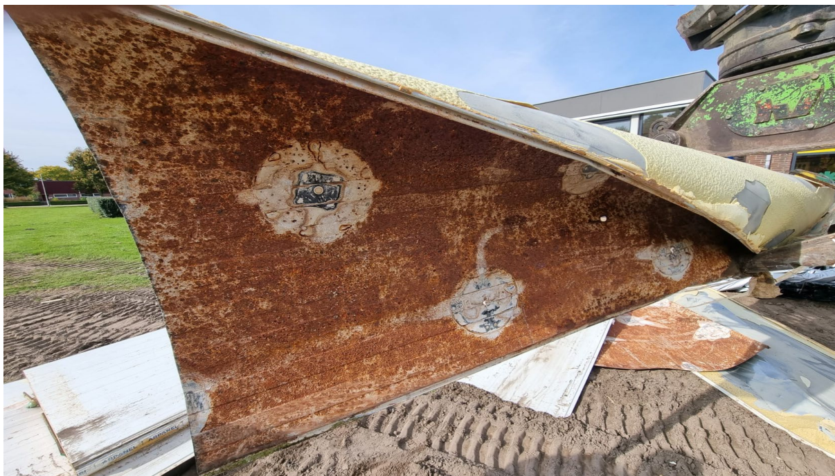
Fig. 9 Zwart metalen (carbon steel) buitenmantel van isoleren deklaag, welke geheel loskomt van de isolatie. Tevens roestvorming door langdurige blootstelling aan vocht in combinatie met luchtlaag tussen verwarmd bufferwater en isolerende deklaag
