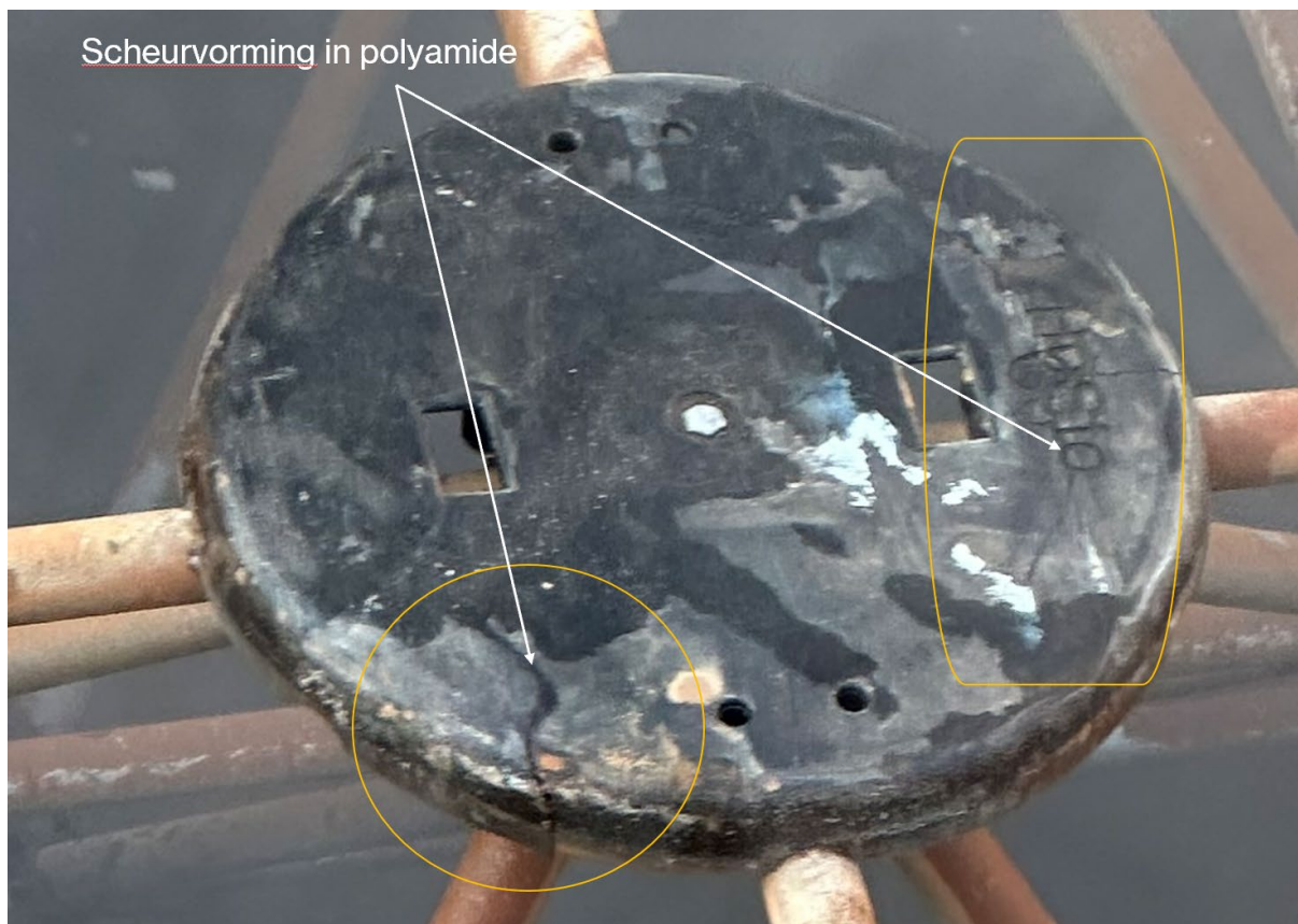
Fig. 13 Scheurvorming in polyamide steunplaat.
