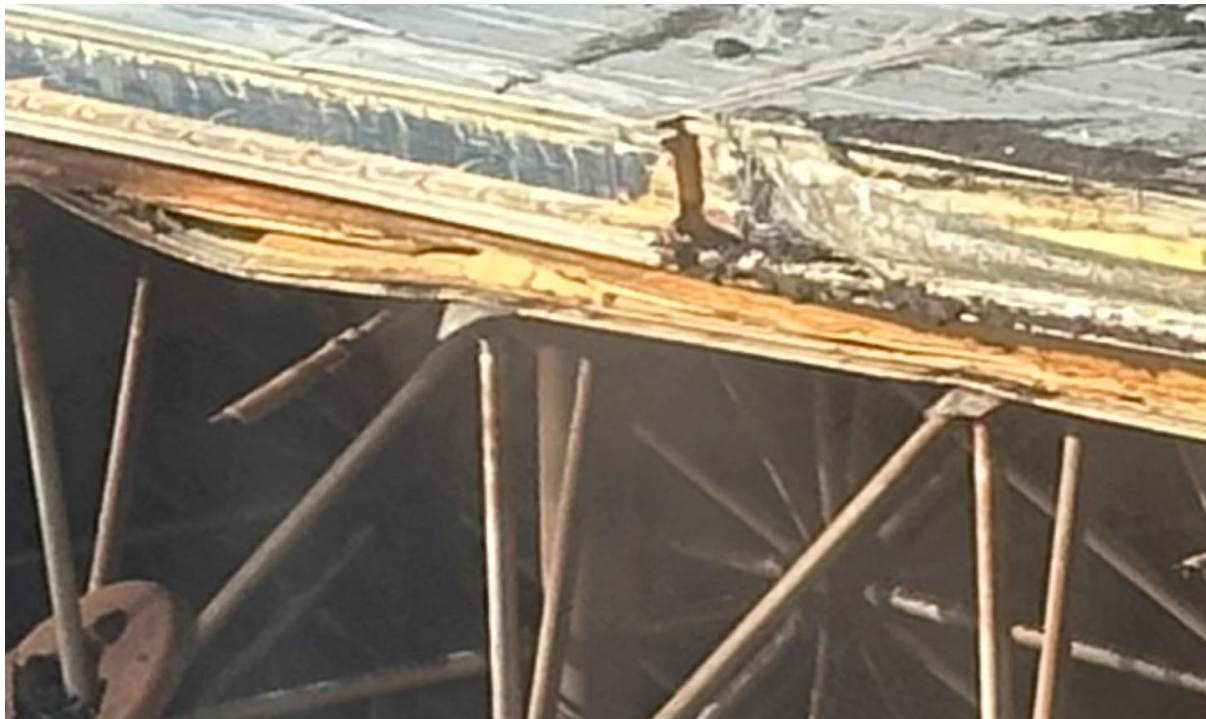
Fig. 11 Dubbele isolerende deklaag. Onderste deklaag vertoont verkleuring door langdurige blootstelling aan vochtname. Bovenste deklaag vertoonde eveneens vochtname en lichtere verkleuring. Kopse kanten van dekplaten staan ca 2 à 3 cm open t.o.v. elkaar. Dubbele isolatiedeklaag van 2 x 12 cm is 9 cm overlappend in lengterichting geïnstalleerd (niet haaks op elkaar). Tevens zichtbaar de ronde disc die al eerder bezwaken is.
